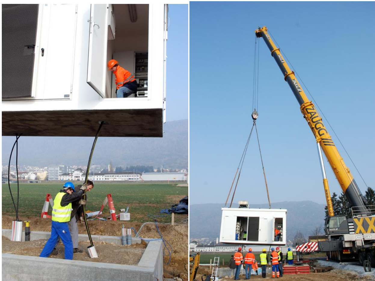
Montage und Einbau der Kompressionseinheit der neuen Erdgastankstelle bei der LANDI Grenchen. (Foto: swg)
