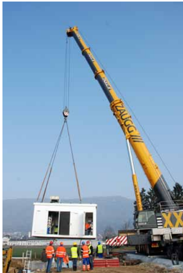
MONTAGE UND EINBAU DER KOMPRESSIONSEINHEIT DER NEUEN ERDGASTANKSTELLE BEI DER LANDI GRENCHEN.
