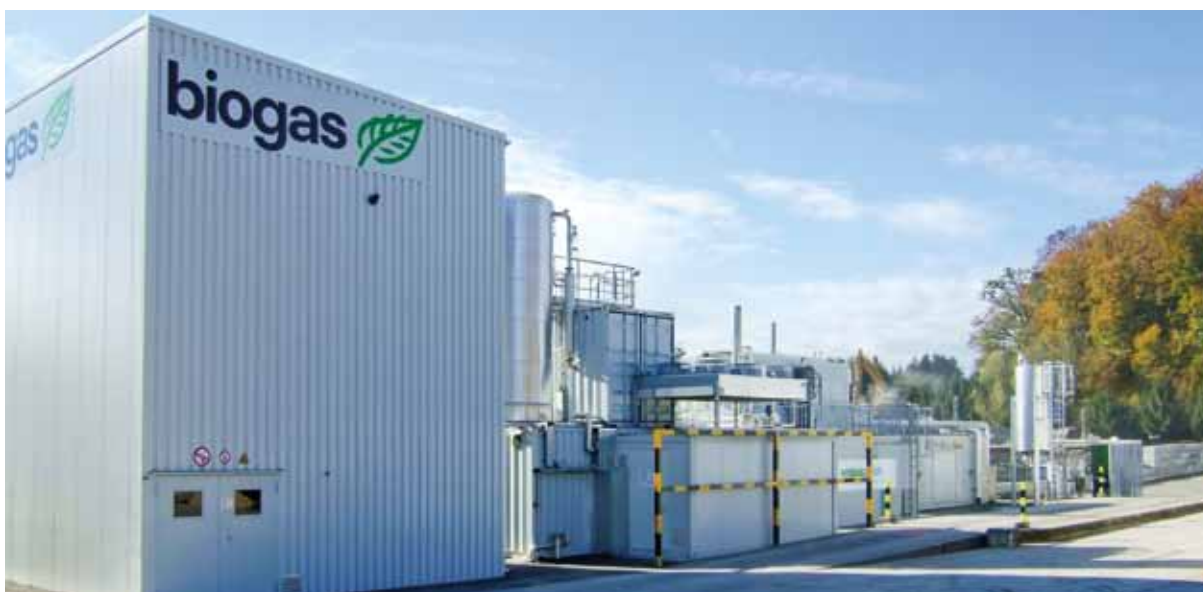
BIOGASANLAGE VON ERDGAS ZÜRICH IN VOLKETSCHWIL.
